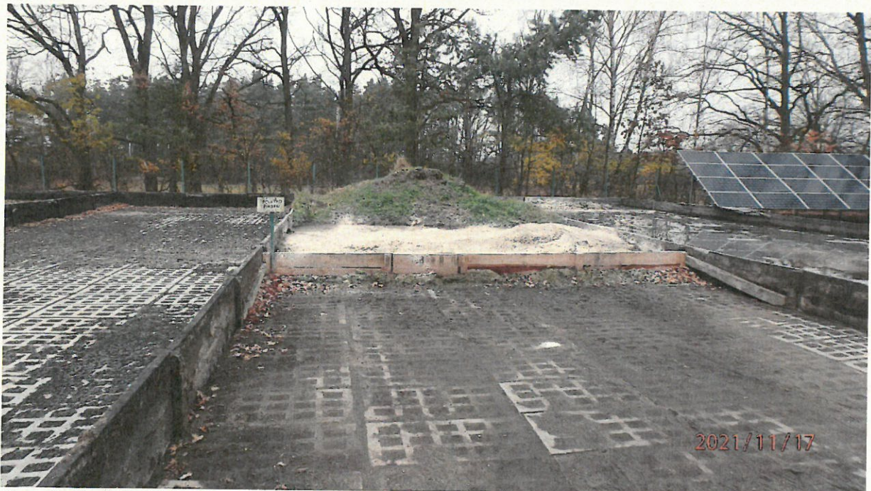
Ryc. 2 Kontrola Zakładu Usług Komunalnych Tworóg Sp. z o.o. ul. Zamkowa 16 42-690 obiekt: oczyszczalnia ścieków w Tworogu, widok na magazynowane odpady o kodzie 19 08 02 (zawartość piaskowników) na poletku znajdującym się na terenie oczyszczalni ścieków w Tworogu
